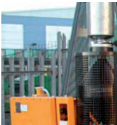
Figura 41 - Caja ignífuga de sistema de combustible.
